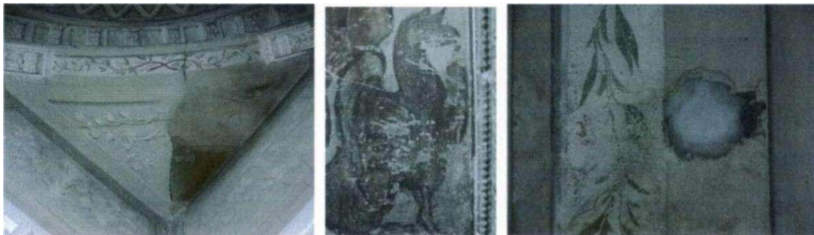
Fot.1.,2.,3- Stan zachowania polichromii, widoczne zacieki zarysowania, oraz cementowe uzupełnienia
